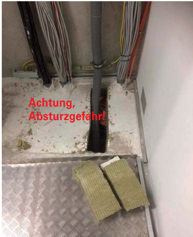
Bsp.: 9_Öffnung einer KMF-Abschottung
